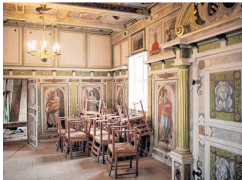
Bis zum Ende des Jahres sollen die Arbeiten abgeschlossen sein. Dann steht auch das Weinbaumuseum wieder für Besucher offen.
